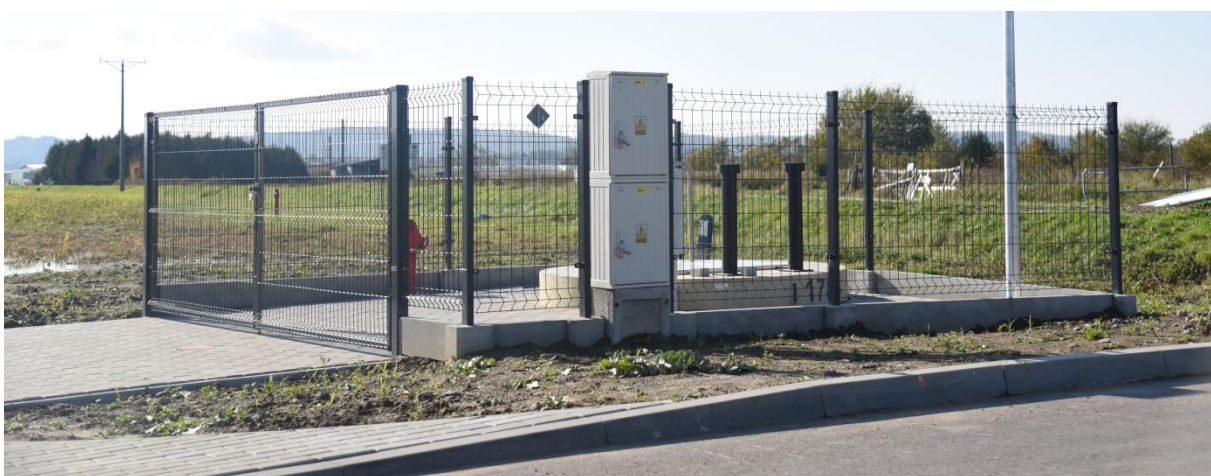
Pompownia na terenie strefy ekonomicznej w Boguchwale -----
